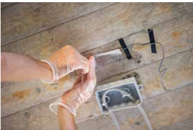
1 Montage eines Beton-Dehnungssensors © Büro für Strukturmechanik
